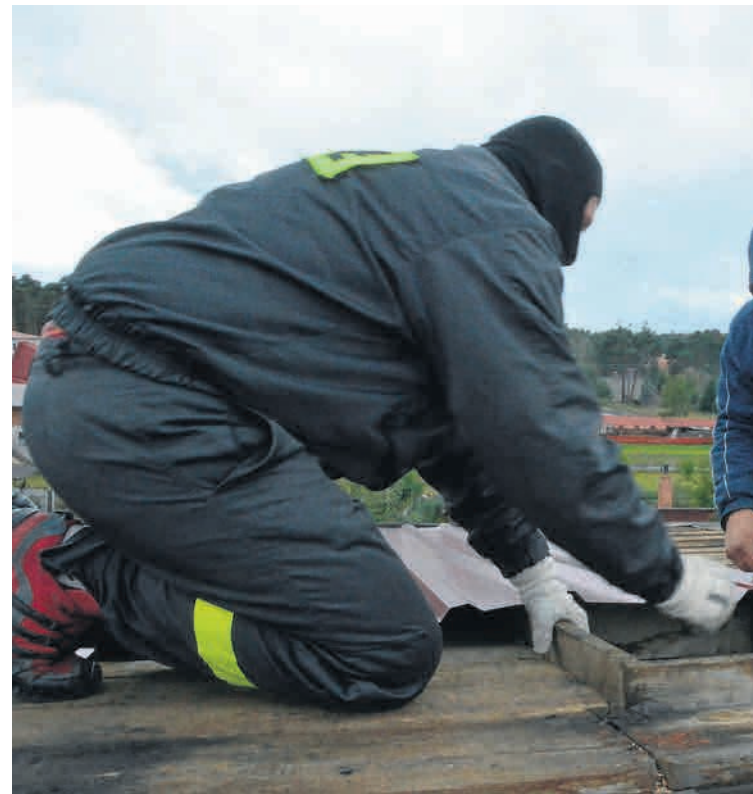
► Mieszkańcy na bieżąco, we własnym zakresie starali się łątać dziury po ze-
