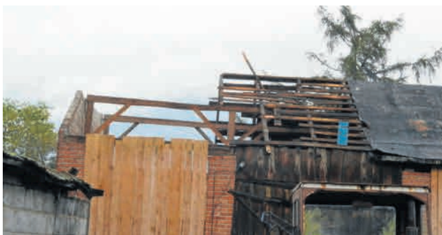
► Zerwany dach na stodołę Danuty Woszczyk trzeba będzie naprawić jeszcze przed zimą, by w środku schować opał
